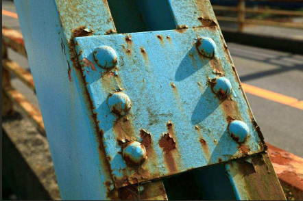
Bild 2: Korrosionsschäden an Metallnieten
